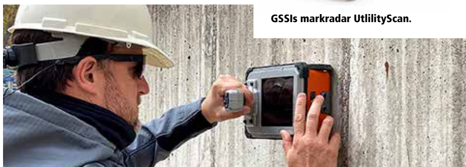
Snabbt och enkelt kan entreprenören utröna vad som gömmer sig i betongen.
